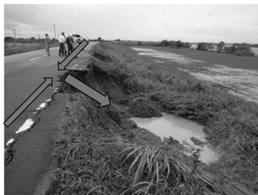
図-1 被災状況(筑後川, 2015 年 8 月)
